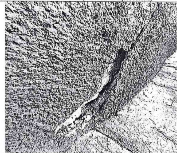
Afectaciones en barda
